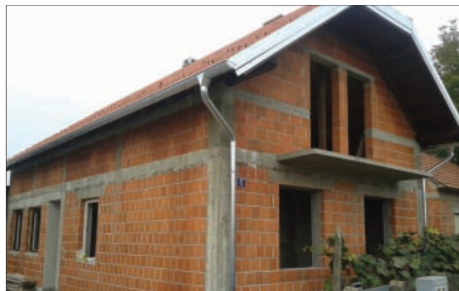
Općina Sveti Đurđ uključila se je i u izgradnju obiteljske kuće obitelji Tuksor iz Karlovca Ludbreškog koja je izgorjela u požaru.
